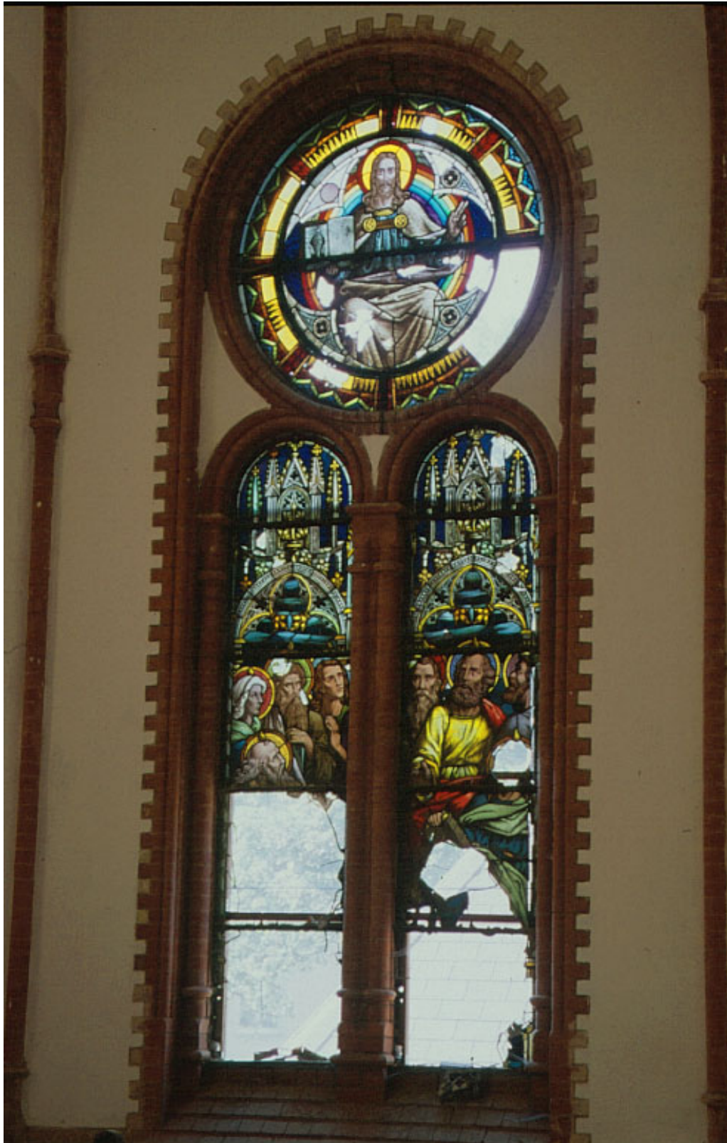
Fenster I, Pfingswunder und im Maßwerkokuli Christus als Weltenrichter; Die Felder 1a,2a, und 1b vollkommen zerstört, das Feld 2b mit erheblichen Fehlstellen.
